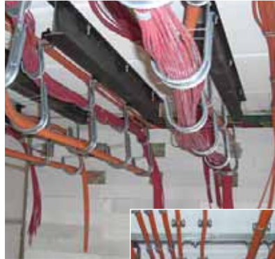
Instalacja w komorze ogniowej
